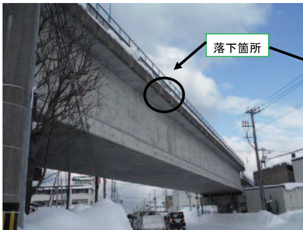
写真1 落下箇所(全景)
