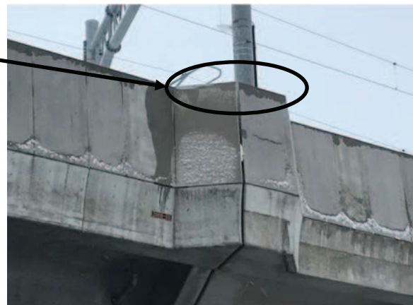
写真2 落下箇所(高欄)
