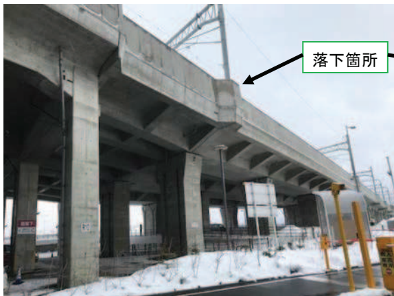
写真1 落下箇所(全景)
